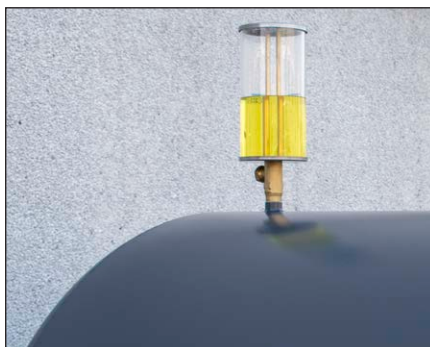
Sistema rilevamento perdite a glicole
