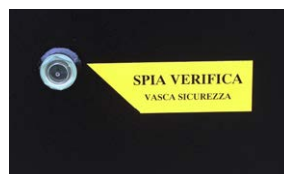
Spia verifica vasca sicurezza
