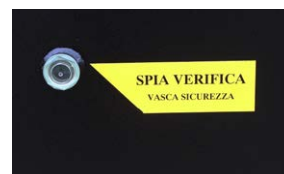
Spia verifica vasca sicurezza
