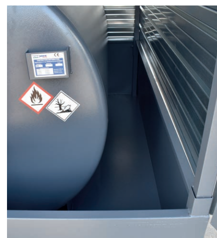
Interno accessibile per pulizie e manutenzioni
