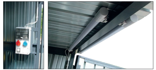
Impianto elettrico e illuminazione
