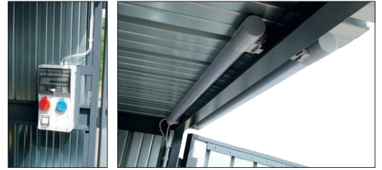
Elektrisches System und Beleuchtung
