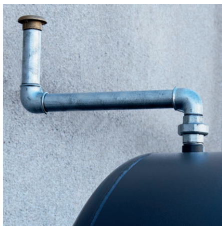
Entlüftungsrohr mit 2,40 mt.
